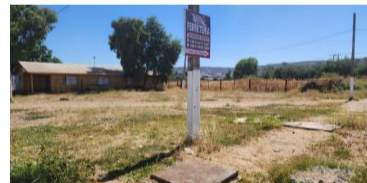
POSTACIÓN Y CÁMARAS EXISTENTES
